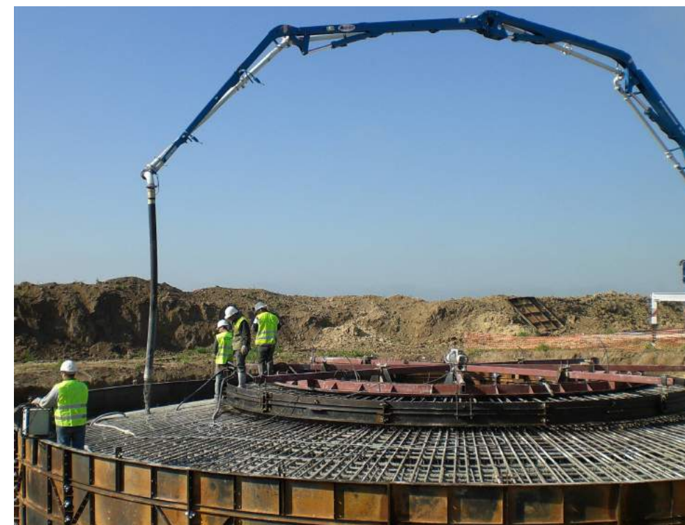
Photo 15 : Exemple de coulage du béton de fondation d'éolienne (Source : BE Jacquel et Chatillon)
