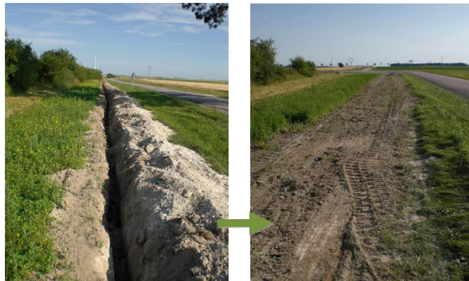
Photo 18 : Rebouchage de tranchée après passage des câbles électriques (Source : BE Jacquiel et Chatillon)
