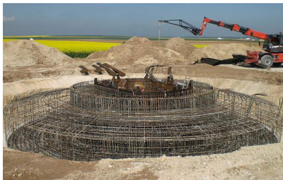
Photo 14 : Exemple de maillage d'acier d'armature pour fondation d'éoliennes de type massif poids (Source : BE Jacquel et Chatillon)
